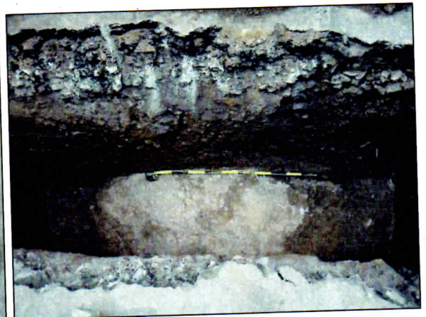
FOTO 04 – Vista en planta de la volta de formigó que donava accés al refugi en aquest punt
